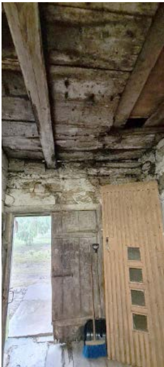
Užvenčio dvaro sodybos gyvenamojo ponų namo medinės perdangos sijos, pažeistos drėgmės ir puvinio. 2024 m.
